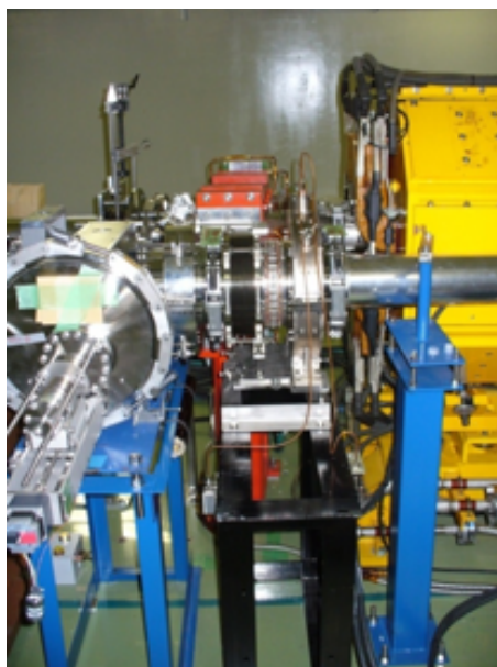
図 7: 速い取り出しラインに設置された Fast Current Transformer (FCT)
