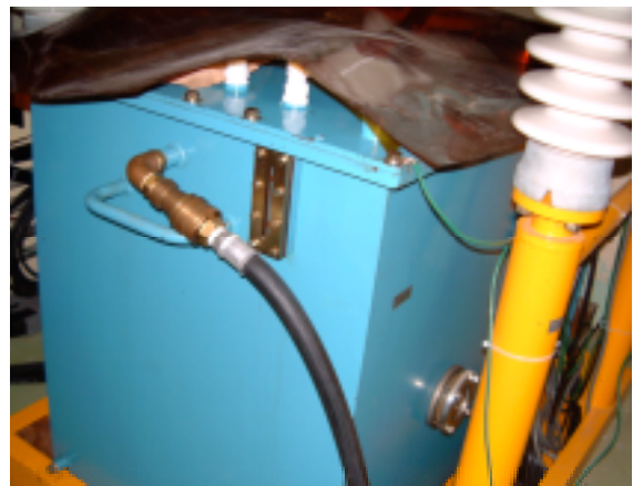
図4：高圧トランスオイルタンク
