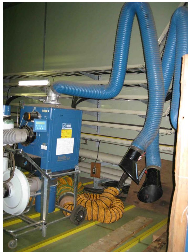
局所排気設備
