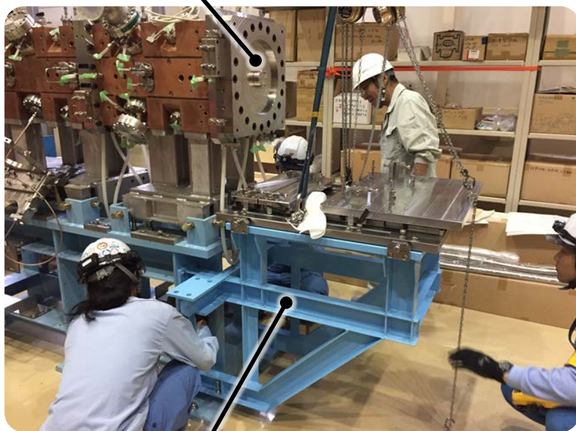
診断ビームライン架台 (新設)
