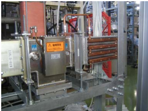
図3：日本高周波製500kWアイソレータ
