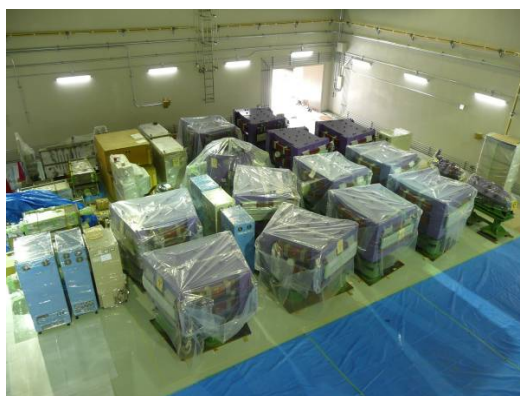
図 3：加速器・ビーム応用科学センター施設加速器本体室（平成20年3月撮影）
