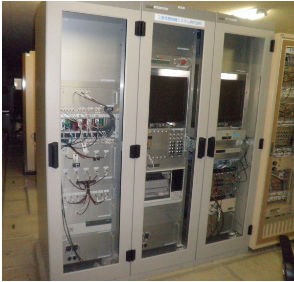
図 1 : D8 電源棟に設置された新 LLRF システム。
